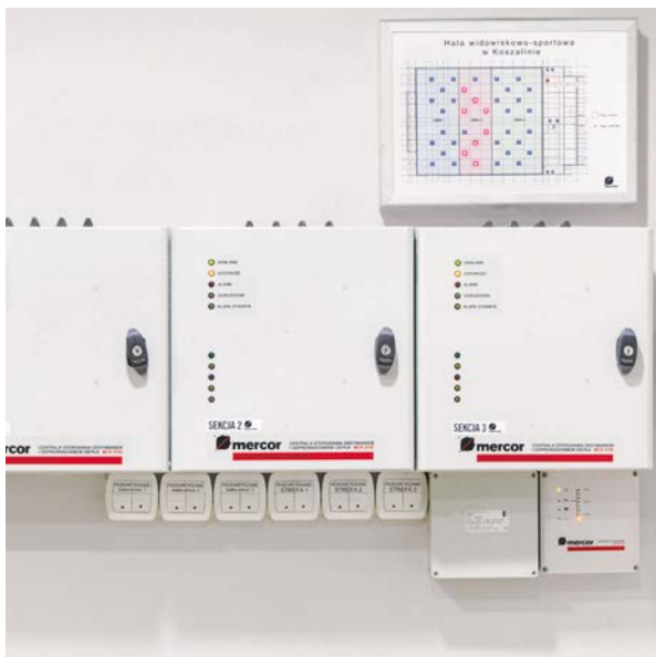
Rys. 2 Przykładowe zastosowanie elektrycznych systemów sterowania oddymianiem
